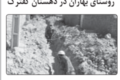
نوسازی و بهسازی شبکه آب آرسنایی روستای بهاران در دهستان کفتک در بخش مرکزی شهرستان توسط شرکت آب و فاضلاب شیراز
