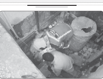
جان باختن کارگری در چاه یک ساختمان در حال ساخت در تهران
